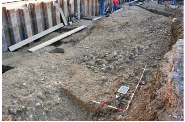
315 Faza 4b, S1. Srednjeveški roparski jarek SE 4045, zapolnjen s SE 4031, sta prekrili plasti SE 4047 in 4058. Pogled proti jugu.
