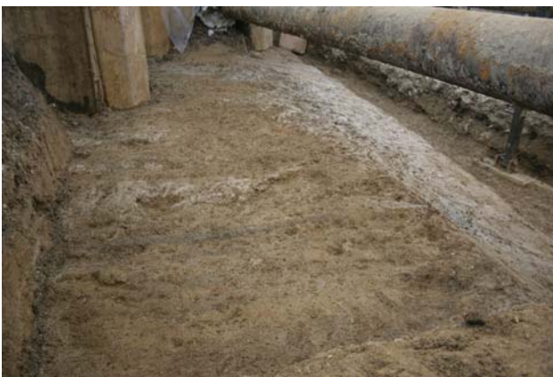
164 Faza 3a1, Križišče. odtisi brun SE 5162 na nasutju SE 5133. Pogled proti severu.
