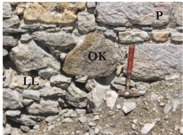
Slika 9.6: Kos oligocenskega drobnozrnatega konglomerata (OK) v zidu stolpa. Povodski apnenec (P) je že del saniranega vogala stolpa. Lokalni lomljenci (LL) so del originalnega zidu.
