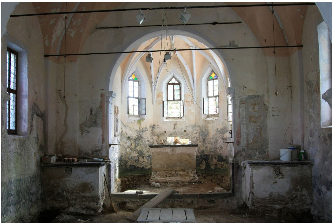
Pogled v notranjščino cerkve med sanacijskimi deli in pred konservatorsko-restavratorskimi posegi. Foto: Vid Klančar, 2012
