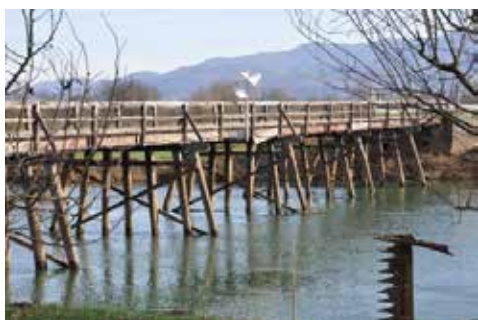
Slika 1: Most pred odstranitvijo (Foto: Judita Podgornik Zaletelj)
