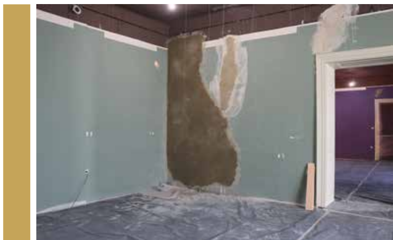
Slika 2: Po linijskem injektiranju so se linijske razpoke dodatno sanirale z ojačitveno mrežico iz steklenih vlaken. (Foto: Posavski muzej Brežice)
