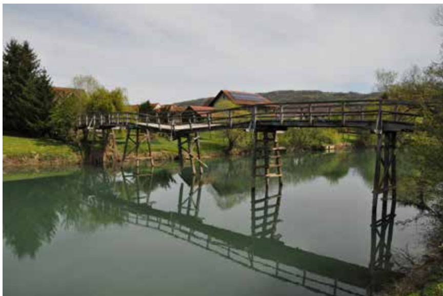
Slika 2: Med poplavami poleti 2023 poškodovana Tercialska brv (Foto: Judita Podgornik Zaletelj)
