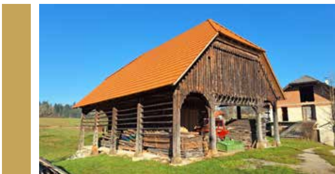
Slika 2: Skedenj po gradbeno-obrtniških posegih leta 2023 (Foto: Dušan Štepec)
