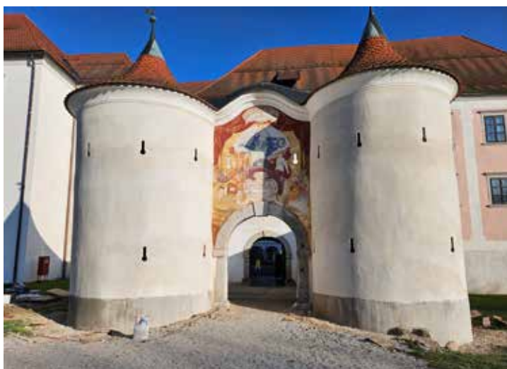
Slika 2: Konstrukcijsko sanirana stolpiča z novim ometom iz hidravličnega apna leta 2024 (Foto: Goran Milovanović)
