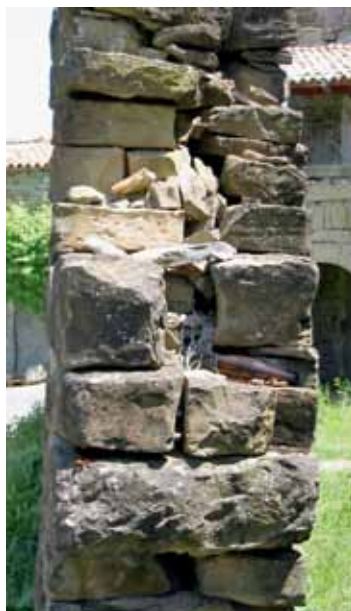
Delno porušen dvorišni zid v Topolovcu kaže prerez dvoziidnega suhozida Djelomično srušeni dvorišni zid u Topolovcu pokazuje presjek dvostrukog suhozida
