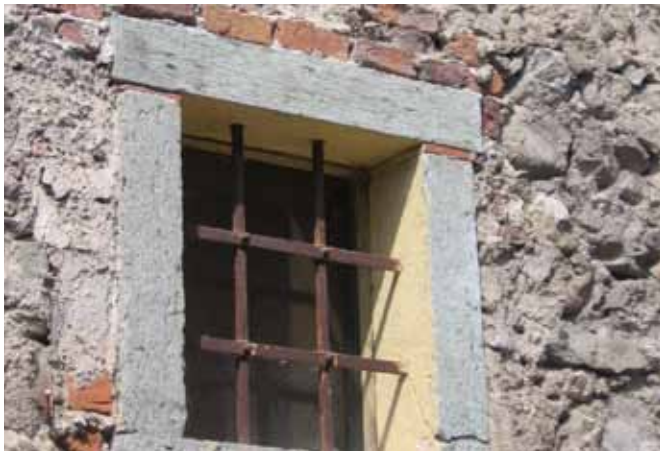
Slika/Abbildung 19: Ker je omet z leti odpadel, je kamnita gradnja jasno vidna. / Weil der Putz mit den Jahren abgefallen ist, wurde der Steinbau klar sichtbar (Leše pri Tržiču)
