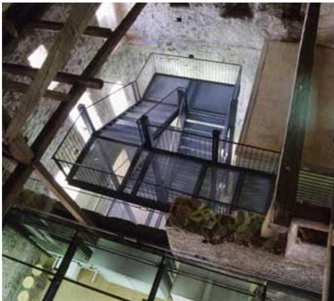
Slika/Abbildung 108: Stopnišče - tehnična vzgoja. Staro in novo v zanimivem dialogu - med zidove vstavljeno stopnišče in zastekljene delavnice. / Stiegenaufgang Werkerziehung. Alt und neu im spannenden Dialog – der eingepasste Stiegenaufgang zu den verglasten Werkräumen.
