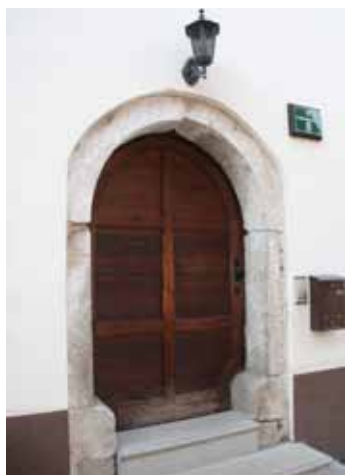
Slika/Abbildung 95: Izvedba toplotne izolacije na fasadah z bogatimi kamnoseškimi detajli ni primerna, ker privede do njihove utopitve v omete. / Eine Ausführung der Wärmedämmung an Fassaden mit reichen Steinmetzdetails ist nicht angebracht, weil die Details in der neuen Außenschicht untergehen.
