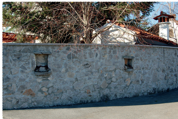
[55] Pretirana uporaba malte izniči lepoto kamna. Slepa okna na zunanji strani zidu so nefunkcionalna in niso v okras. F.: E. Belingar
