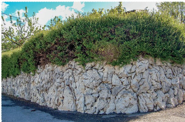
[52] Pretirana uporaba korozijsko izjedjenih kamnin v zidu. F.: E. Belingar
