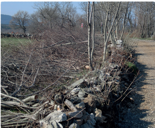
[48] Suhi zid se je porušil zaradi bioerozije in nevdzdrževanja. F.: M. Jeršek
