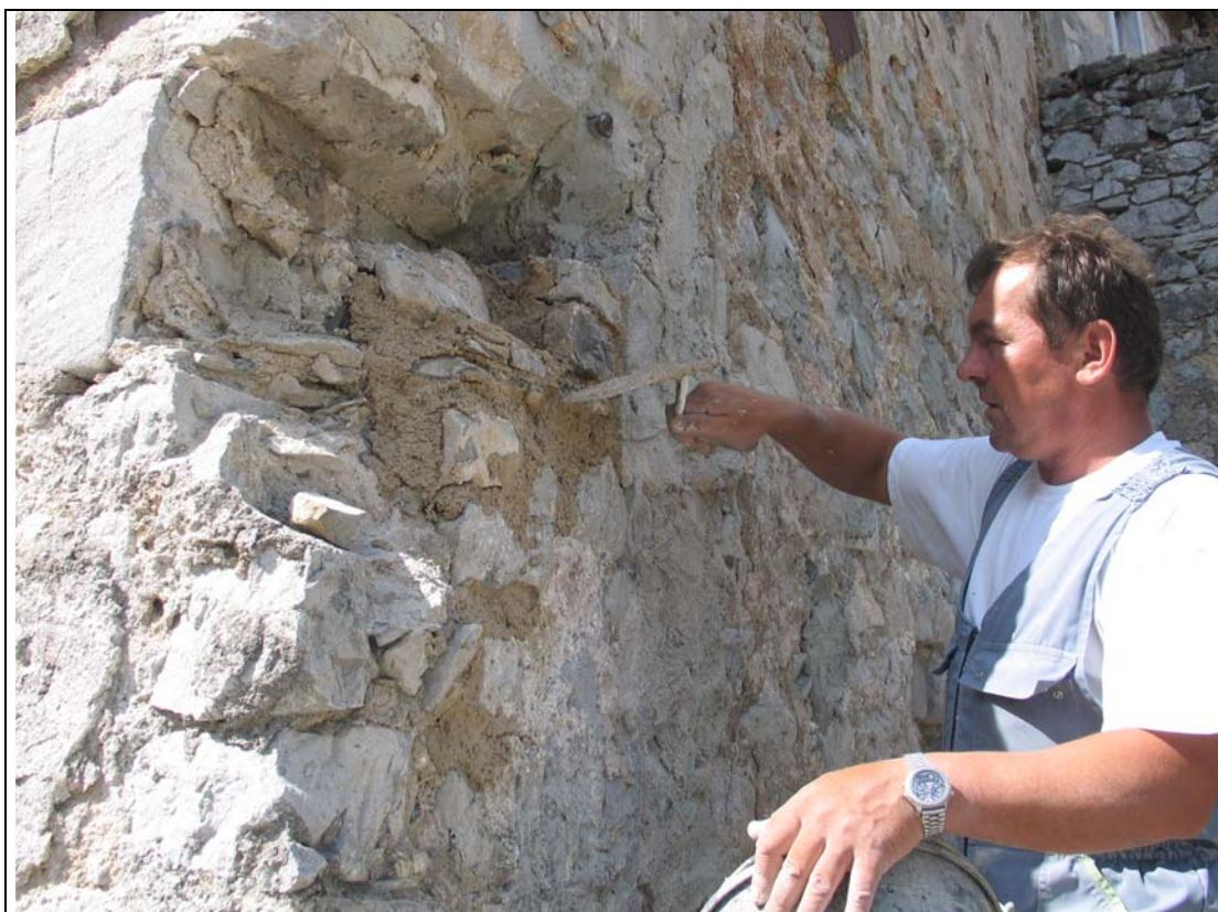
Primer na objektu hiše Markočič, poškodba zidu
