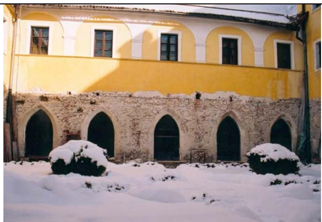
10 Severna fasada križnega vrta z vidno prvotno višino križnega hodnika (linija zidave nad ločnimi odprtinami) in opečnimi polnili na mestih nekdanjih opornikov.
