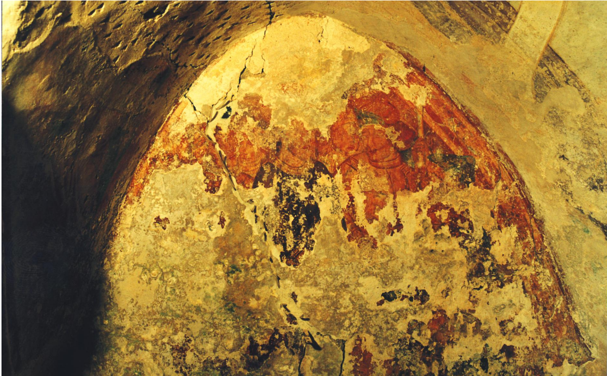
Vzhodna stena zgoraj med injektiranjem in odstranjevanjem zasiganih ometov in beležev ter soli. Istočasno smo tudi pozidavali večje razpoke in injektirali.
