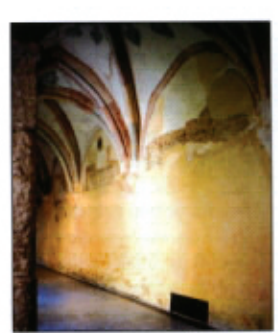
Notranje ostenje v zahodnem hodniku z vidnimi posledicami kapilarne vlage ter sondo na stiku dveh značilnih gradbenih tehnik, romanskega pritličja (svetlejša malta) in nadzidave (živoapnena malta)
