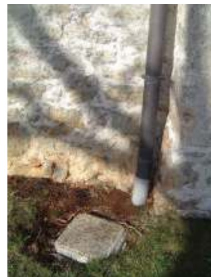
Strešna voda, speljana v meteorno kanalizacijo preko peskolova - jaška, ki zadrži trde delce. V primeru odvajanja deževnice v štirno so bili tradicionalno uporabljeni tudi drugi preprosti filtri, ki zagotavljajo boljše kakovost zbrane vode. Avtor fotografije: Nataša Kolenc
