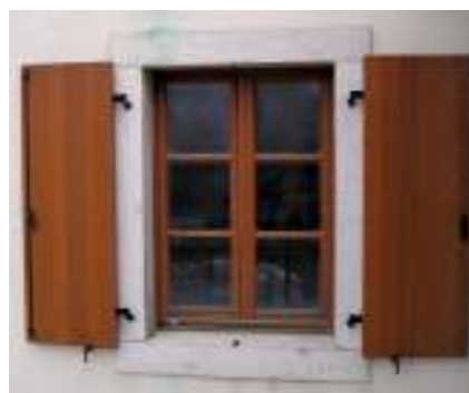
Klanec pri Kozini - polkna in okenska krila so izdelana kot replika originala in delujejo skladno. Vir: Arhiv OCRA Obrtni center restavradorstva d.o.o.
