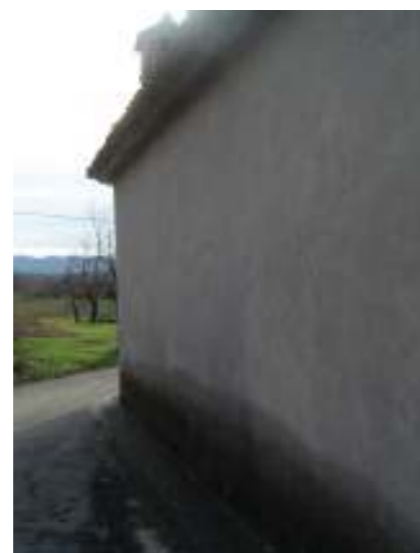
Streha brez žlebov in nepravilno izveden stik stavbe s tlemi omogoča pronicanje velikih količin vlage direktno v steno stavbe. Avtor fotografije: Nataša Kolenc
