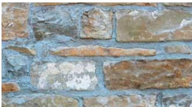
Foto 51: Šmarje, primer slabe obnove kamnitega zida s cementnimi fugami
