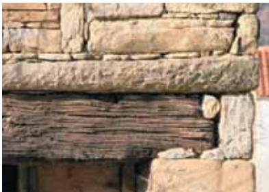
Foto 39: Kamnita podpora razbremenilne preklade
