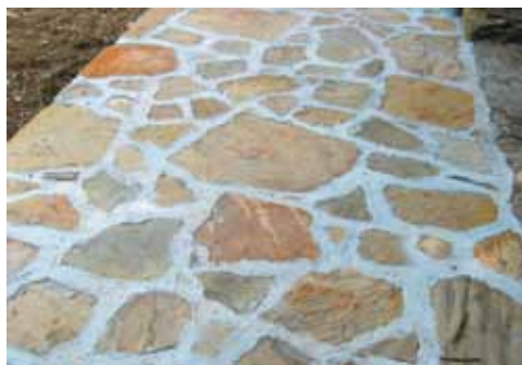
Foto 128: Napačno obnovljen dvoriščni tlak z betonskimi fugami v Topolovcu
