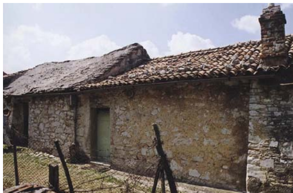
Slika 61 Na stavbi v gornjem delu Štanjela je cela streha zalita s cemento malto.
