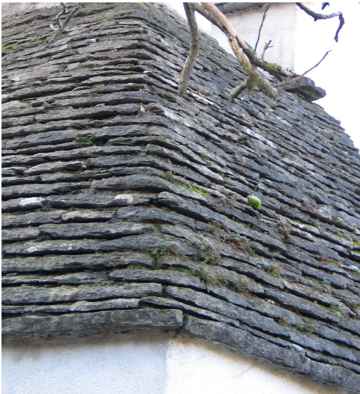
Slika 76 Debele plasti malte med skrilami v obnovljeni strehi ne prispevajo h kakovosti kritja (foto: Mateja Kavčič).
