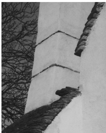
Slika 43 Pomolno položena globel (žlota) iz klesanega kamna na strehi kotne spahnjenice pri Škrateljnovi hiši v Divači.
