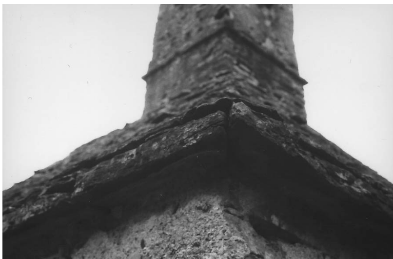
Slika 31 V grebenu strehe na spahnjenici pri Šobčevih na Kalu si v plasteh izmenoma sledijo pari polovičnih grebenjakov in celi grebenjaki. V špranje med plastmi grebenjakov so potaknjene tenke skrilice, da greben ne zija.
