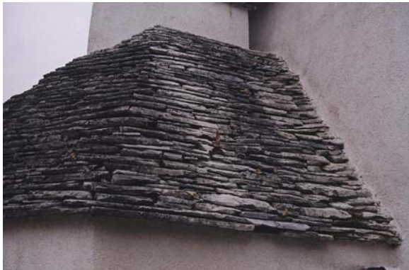
Slika 22 Tanjše skrile brez poševno posnetih čel na strehi spahnjenice Venckovih v Matavunu.
