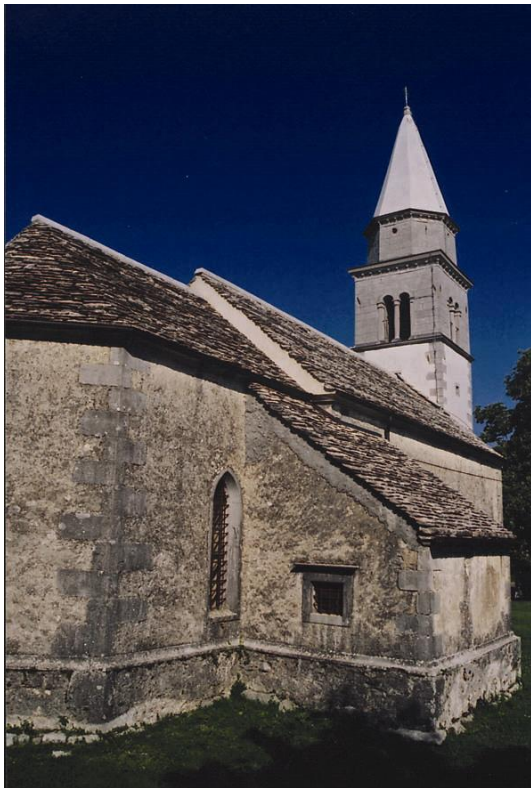
Slika 66 Cerkev sv. Križa v Križu pri Sežani z obnovljenimi strehami. - Pri tem niso ustrezno obnovili in prilagodili odpadlega ometa pod kapom zakristije.
