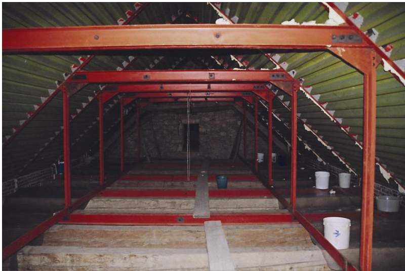
Slika 68 Cerkev Marijinega vnebovzetja na Repentabru: nova jeklena strešna konstrukcija iz povezij s trapeznimi vešali in trapezne pločevine.
