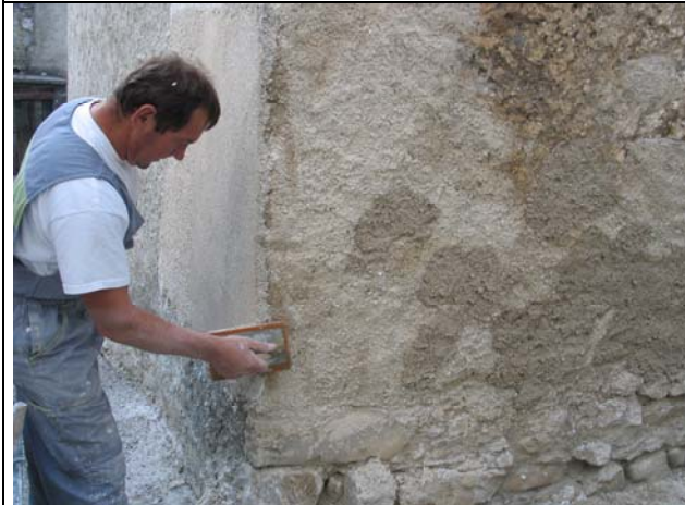
Dvo ali večslojno ometavanje v vdolbinah, poravnavanje vogala - stika med finim ometom in obrizgom
