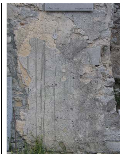
Neustrezne betonske plombe in ostanki injektiranja zidov
