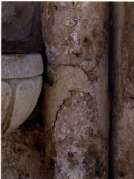
Trdna masa, uporabljena za domodelacijo stika med kamnitimi elementi ostaja, original propada – poškodba se razvija v zadnjih desetletjih!
